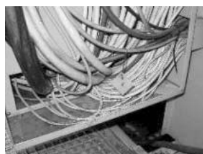
Chladicí emulze v prostoru kabeláže
