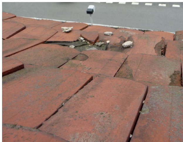
Poškozenou krytinu je třeba vyměnit
