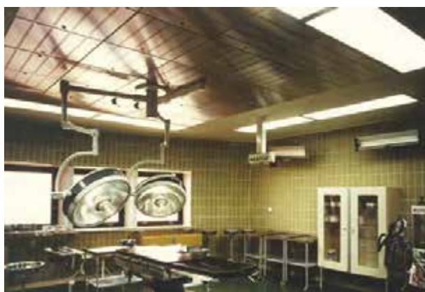
OBR. 6. Operační sál s disperzní klimatizací.
