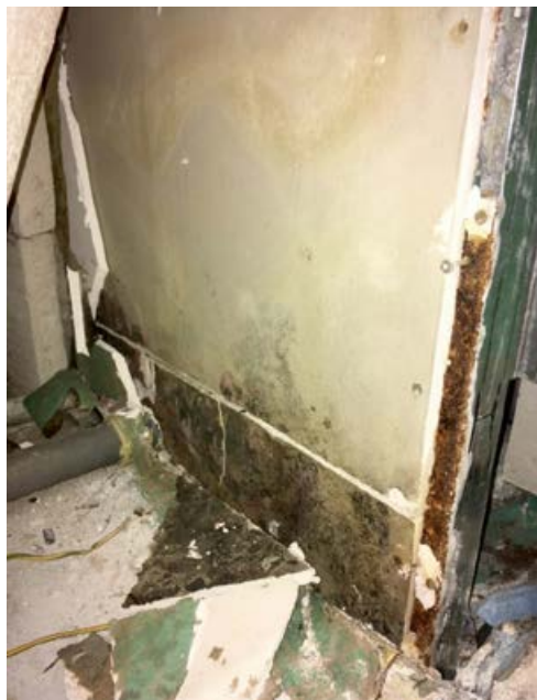
Obrázek 7 Nežádoucí průsak vody v koupelně má za následek vznik plísně na povrchu sádkartonu; takto napadený sádkarton se musí odstranit.
