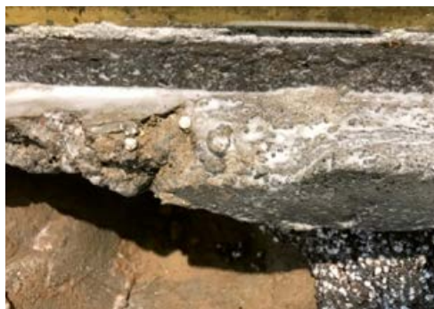
Obrázek 9 Sanace plísní a spor ve vrstvách podlahy systémem micelární hloubkové sanace.
