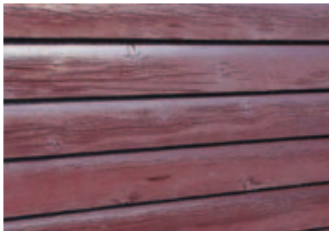
Obr. 2.8 Dřevěná fasáda budovy v přístavu. Tím, že je fasáda vystavena stálé expozici proměnlivého slunečního svitu a počasí, dřevo se vyluhuje a nevyhnutelně vznikají trhliny.
