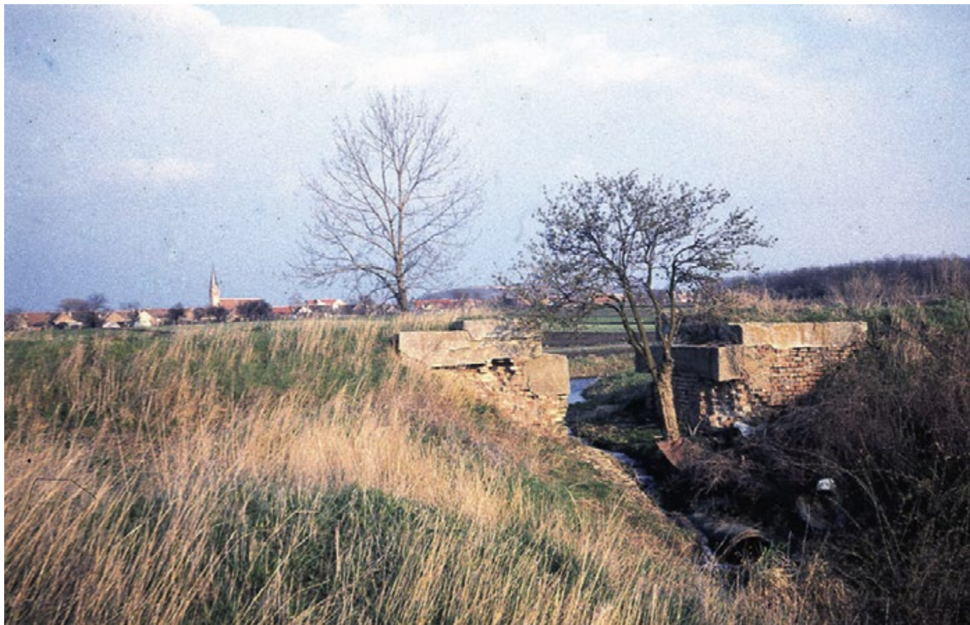
Traťový úsek Novosedly – st. hranice, opěry můstku přes Bystřický potok, v pozadí obec Nový Přerov, 13. dubna 1994, foto Jiří Marek.
