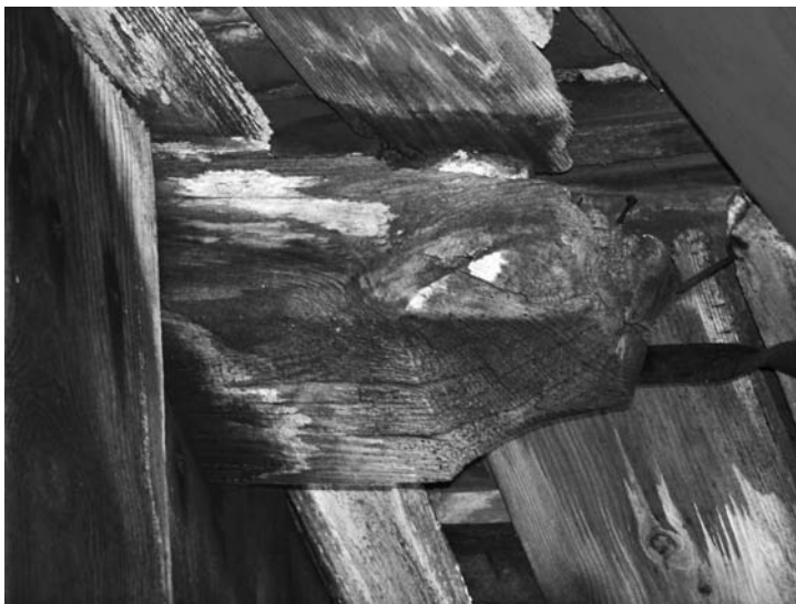
Obr. 4 Poškození krovu způsobené zatěnkáním po krokách
