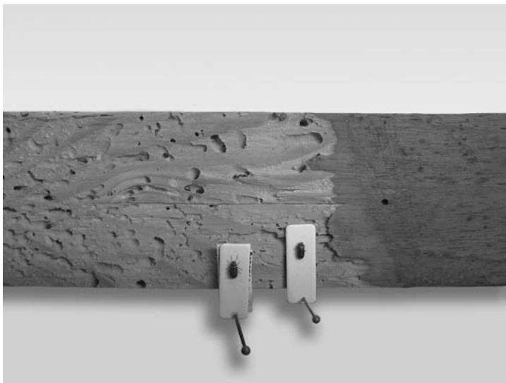
Obr. 1 Dřevo napadené škůdci
